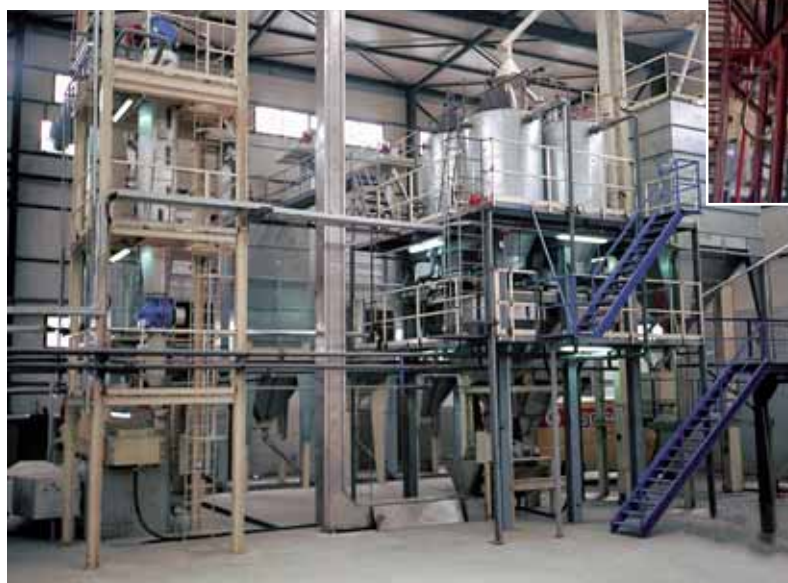
Гидротермическая установка непрерывного действия в Греции (для малых и высоких мощностей)
